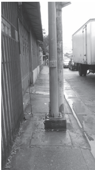
Figura 3. Acera en San José, presenta el poste del semáforo peatonal y un poste de alumbrado público, así como un tensor metálico colocado cerca de los mismos, todos obstruyen el paso. Nota. Elaboración propia.
