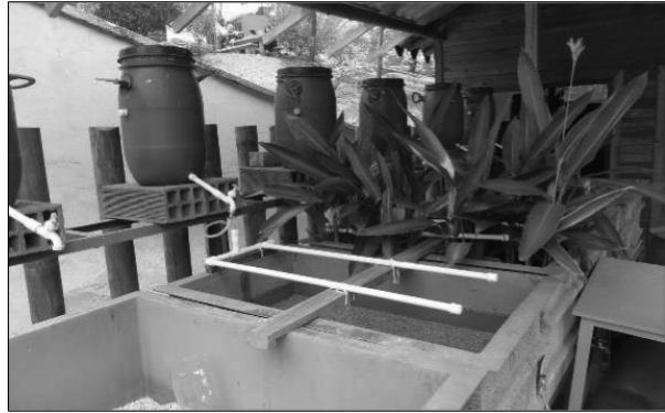
Figura 2. Sistemas de humedales construido. T. de A. Fuente: Elaboración propia (2016)
