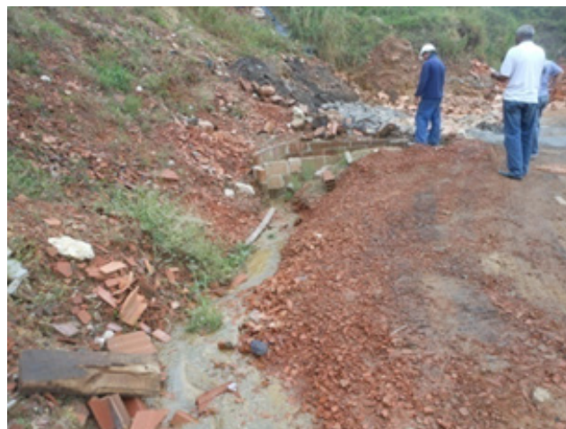
Figura 3. Situación y afectación del suelo, vereda Los Gómez
